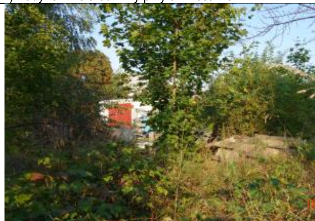
4) Transformator i zieleń ruderalna widok od strony rzeki Łeby
